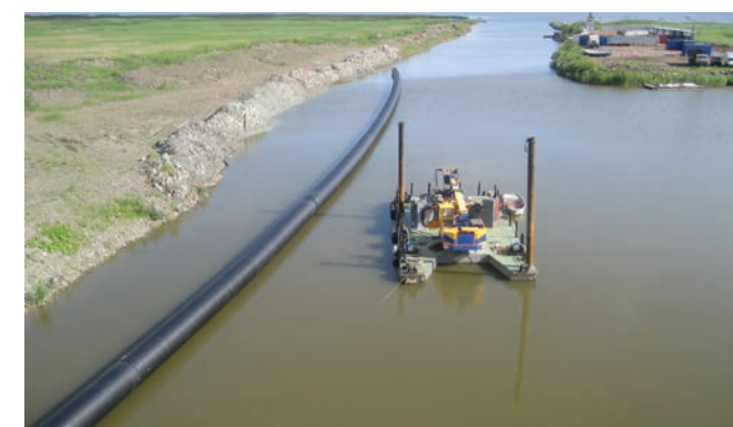
St. Petersburg, Rusland: Udløbsrør til spildevandsanlæg. Uponor leverede 1060 m ID 1200 mm rør samt svejsseservice.
