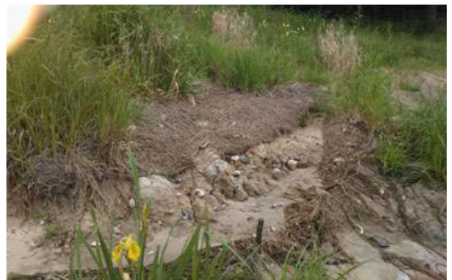
...og skrænten ligger eksponeret for erosionsskader
