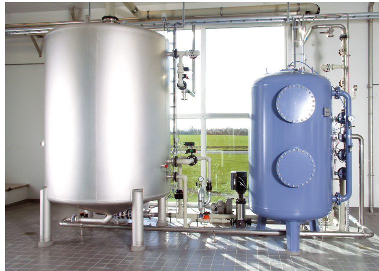
Afblæsning af opløste gasser såsom aggressiv kulsyre, metan og svovlbriente er en forudsætning for en optimal filtrering. Foto: Afblæsning og trykfiltrering på dansk bryggeri.
