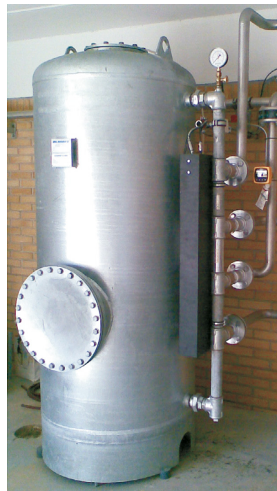
Arsen fjernelse ved adsorption på vandværk i Østjylland. Løsningen består af automatisk trykfilteranlæg NSB 170, som er installeret efter åbne filtre. Ydelsen er 12 m 3 /h.
