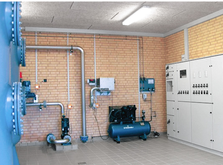
En komplet vandbehandlingsløsning består foruden trykfilter også af teknisk udstyr til iltning og returskylning.
