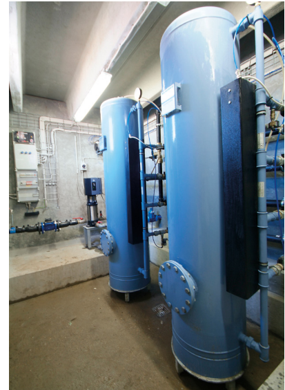
En lang række ejendomme og boliger er beliggende, således at tilslutningen til et større og fælles vandværk ikke er hensigtsmæssigt eller ønskeligt. Den vandbehandlingstekniske løsning hertil tager naturligvis udgangspunkt i de samme grundprincipper som ved de større vandforsyninger. Et trykfilteranlæg type NSB er ideelt til små og mellemstore drikkevandsforsyninger.
